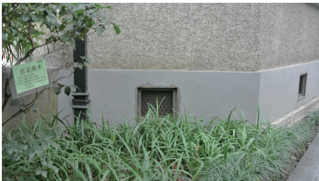
▲ 寓所主楼的出风洞
